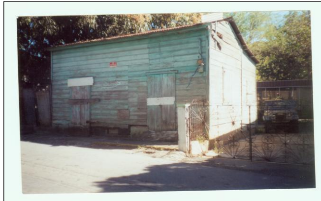
La vieja casona en varias etapas de deterioro (Foto cortesía de Alfredo Velásquez González, Año 2002)
