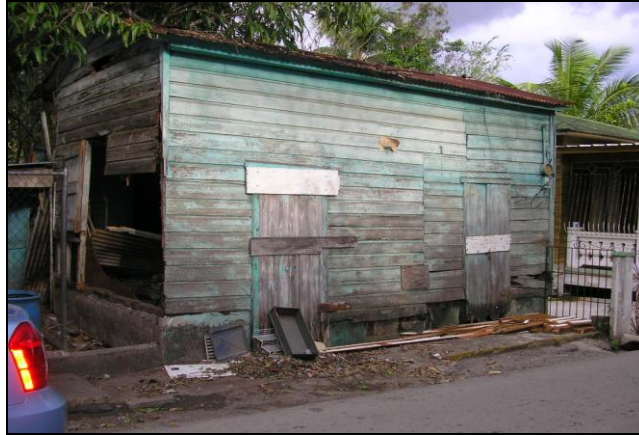
La vieja casona en varias etapas de deterioro (Foto por Carlos Muñoz Medina - Año 2006)
